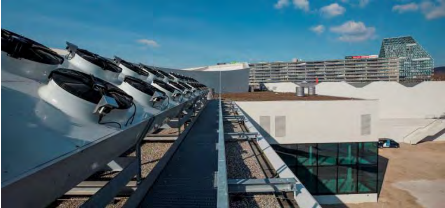
Luftkühler zu Luft-Wasser-Wärmepumpe
