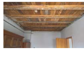
Nicht erhaltenswerte Decken Ertüchtigung wie Neubau
